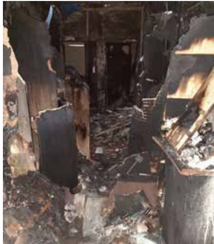
Dachstuhlbrand in Bad Boll
